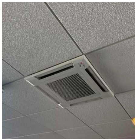
VRF Cassette Unit
